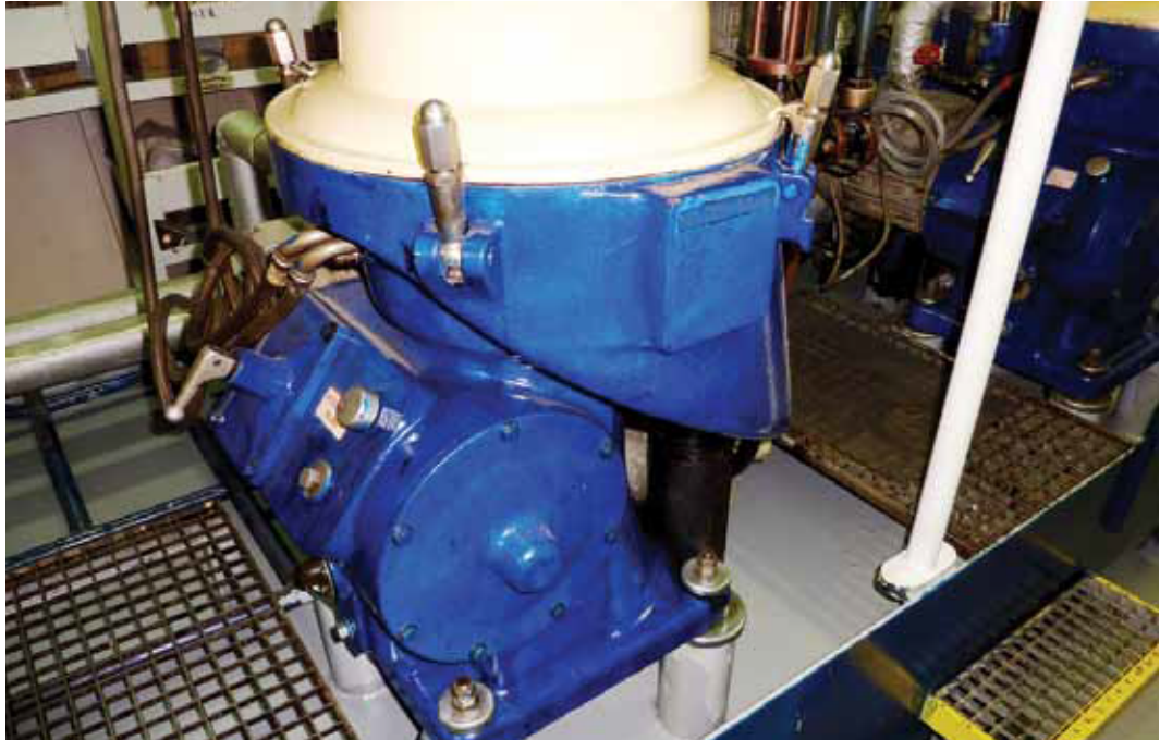
^ Centrifugal separator (purifier)
